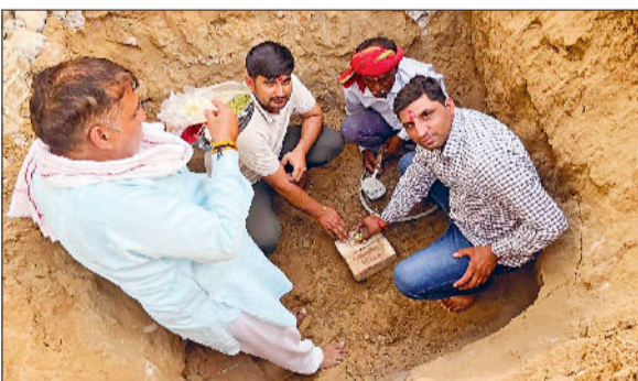
बहल। मंडोलीकलां गांव में शेड निर्माण की आधारशिला रखते पार्षद रविन्द्र मंडोली।
